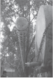
Detalle de la tubería ranurada – Flauta para irrigación FUENTE: PMA, para la fase de operación de la termoelectrica “EL REMANSO” – TERMOPAIPA IV 2004
